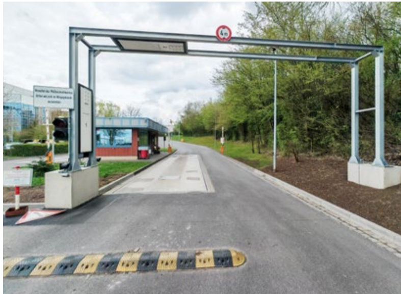
Die neue Portalmessanlage am Müllheizkraftwerk Coburg.
