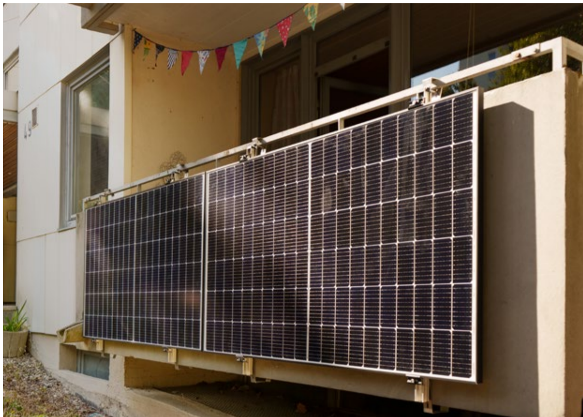
Vierorts wurden in Coburg schon Balkonkraftwerke installiert und von der Stadt gefördert – wie hier im Demo.
