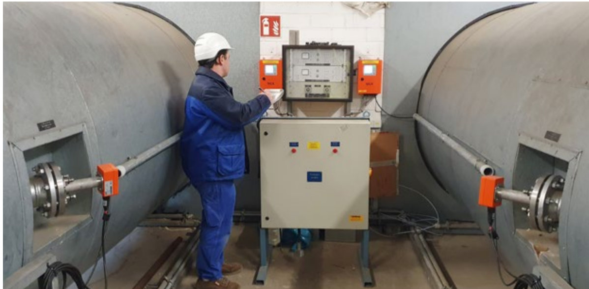
Rauchgas-Messung kurz vor dem Kamin: Die Emissionen und verschiedene Betriebswerte des MHKW Coburg werden permanent mit Hilfe von modernster Messtechnik kontrolliert und per Computer ausgewertet.
