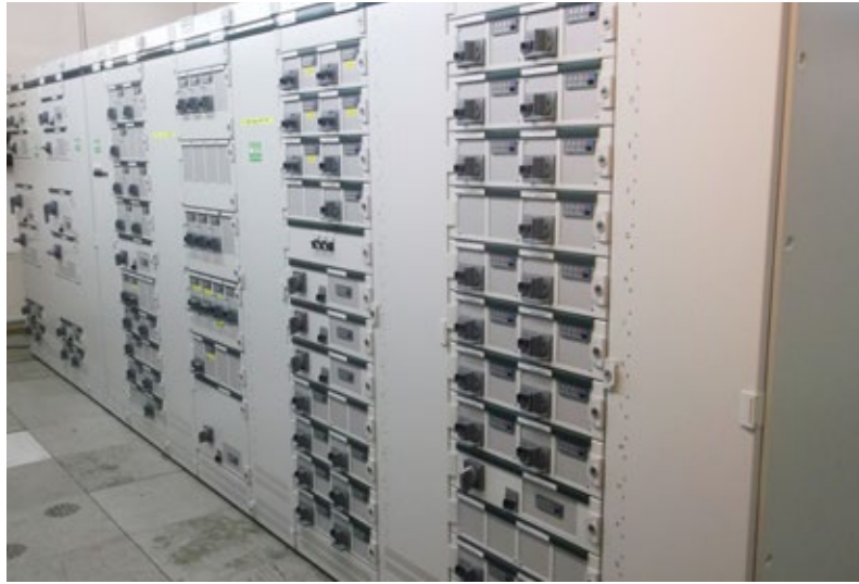
Die Schaltanlagen für die beiden Mülllinien wurden in diesem Jahr auf den neuesten Stand gebracht.
