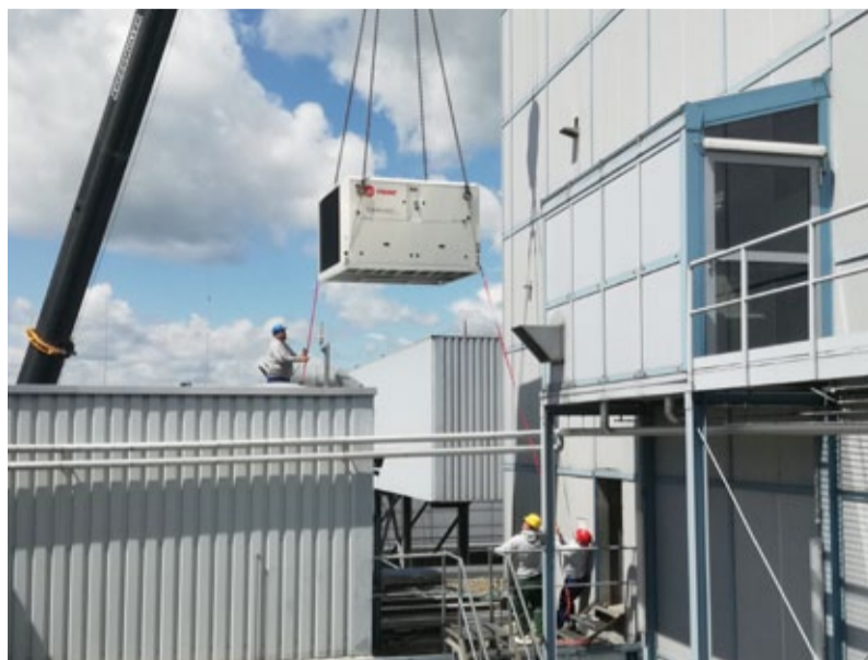
Eine von drei neuen Kältemaschinen für das MHKW wird geliefert.
