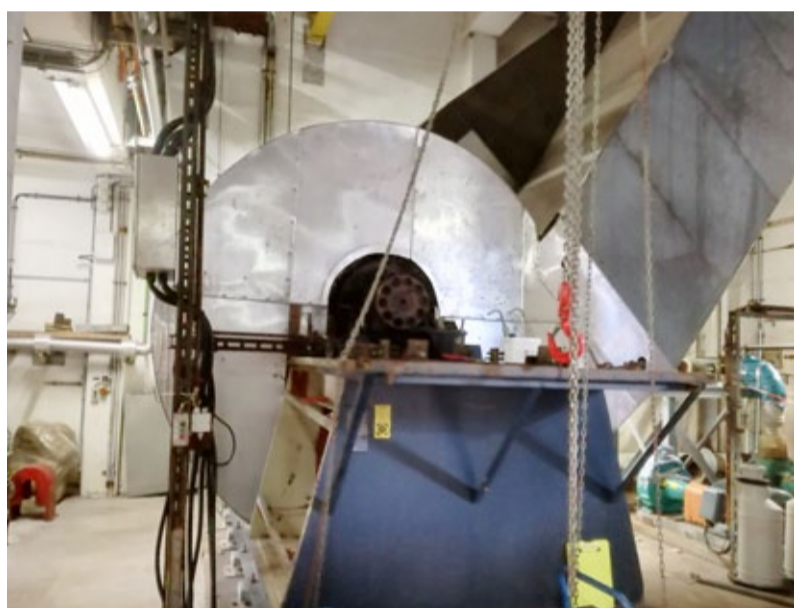
Die Saugzüge in der Rauchgasreinigung wurden mit leistungsfähigeren Antriebsmotoren ausgerüstet.
