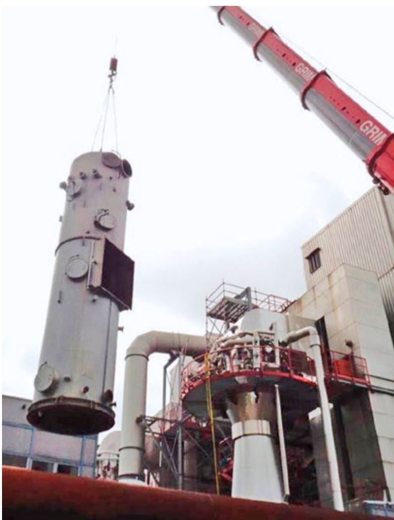
Schwerstarbeit: Der demontierte Radialstrom-Wäscher muss herausgehoben und per Schwertransport zu einer Spezialfirma zur Aufarbeitung gebracht werden. Der Stahl wird saniert und die Innenflächen neu gummiert.
