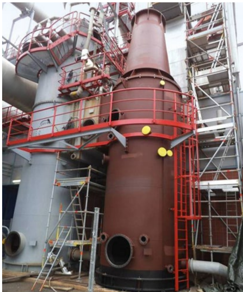
Der sanierte Venturiwäscher für die Raugasreinigung der Linie 1 ist installiert.
